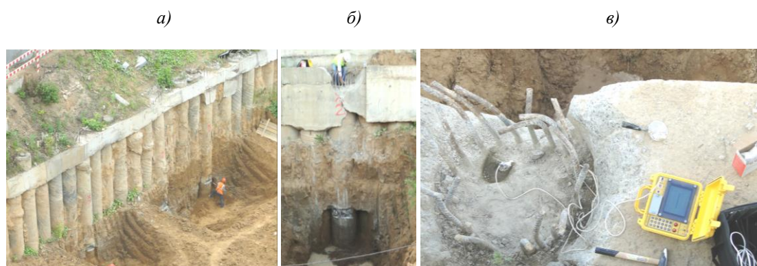
Рис. 4. Освидетельствование технического состояния конструкций удерживающей стены с отметки пионерного котлована (а) и вскрытие железобетонной конструкции обвязочной балки и БНС (б, в)
