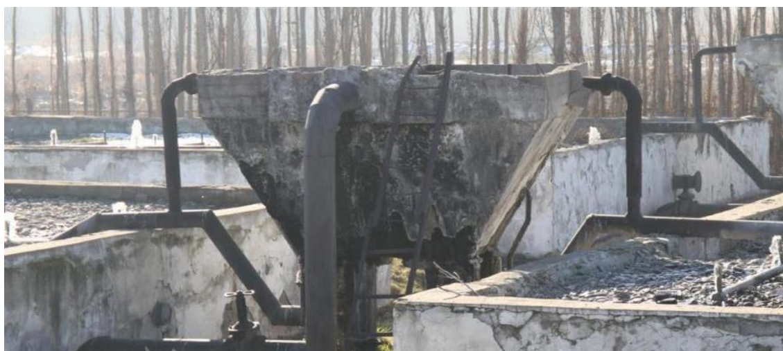
Рис. 5. Распределительная чаша очистных сооружений биологических фильтров города Джалал-Абад
